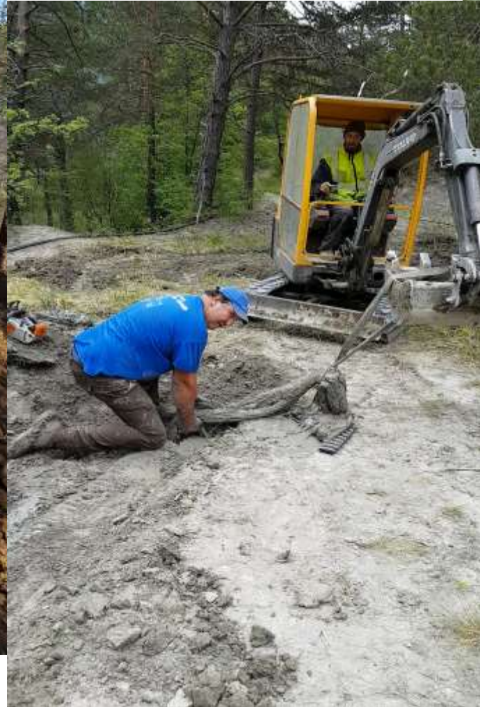
Evacuation d'une racine dans la conduite
