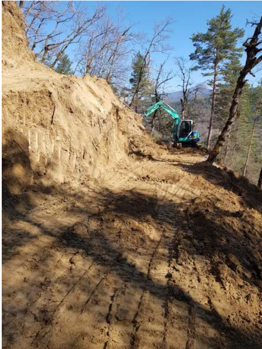
Glissement de terrain sur canal Vélimande
